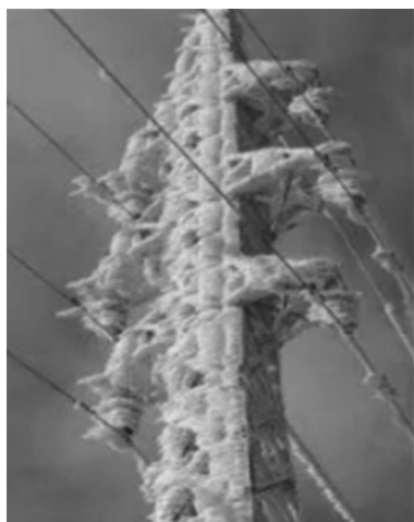
图 4 铁塔覆冰现场观测图
